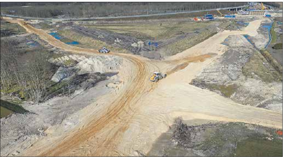
Projektet er udbudt i totalentreprise, som firmaet M. J. Eriksson står for. Firmaet besluttede selv at tage skinner op, som man blev bedt om at lægge ned igen. Men det er ikke sikkert, det koster bygherren ekstra, lyder det fra entreprenøren.
