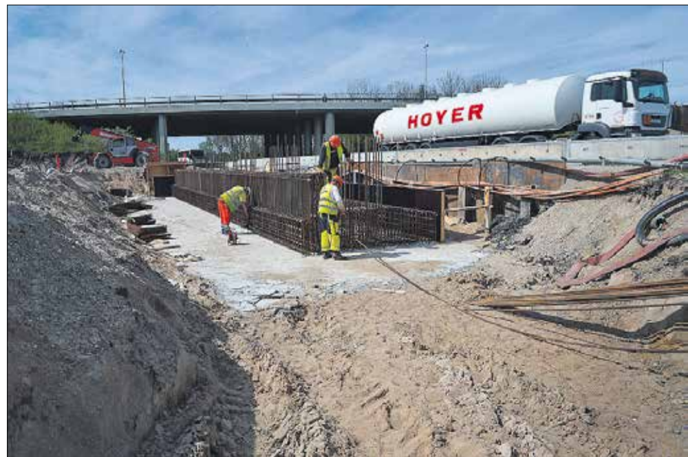
Broen i baggrunden skal fjernes. I stedet gøres klar til at støbe en ny over motorvejen, som er så bred, at den er forberedt til en udvidelse af motorvejen til tre spor.
