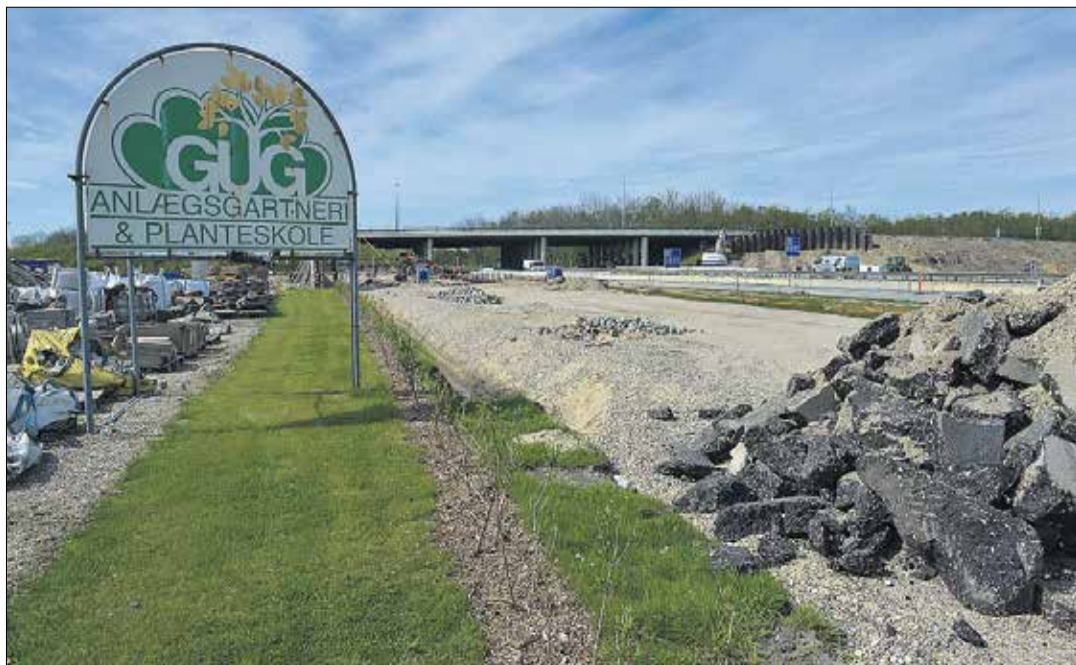
De store udgifter i vejprojektet ligger her ved tilslutningen til motorvejen E45 ud for Gug Planteskole.
